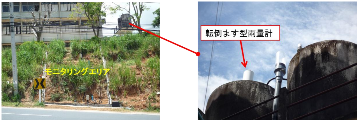
図 3-41 転倒ます型雨量計の設置状況
