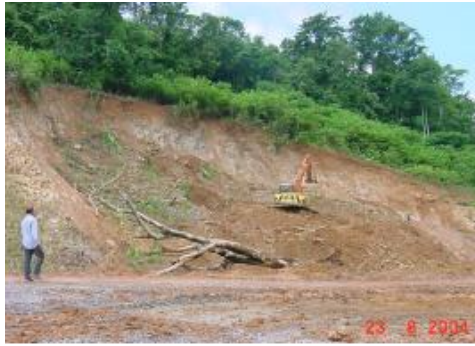
(a) 斜面の崩壊状況（平成 14 年 8 月）
