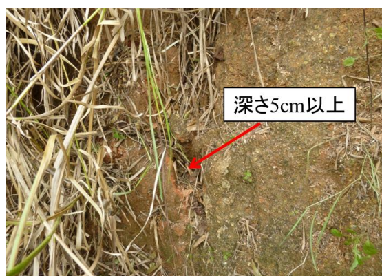
図 5-9 Slope-P における表面浸食の形跡
